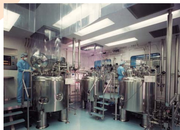
注射液生产设施
