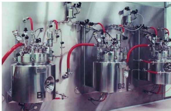
无菌室内骑墙安装的配液罐
